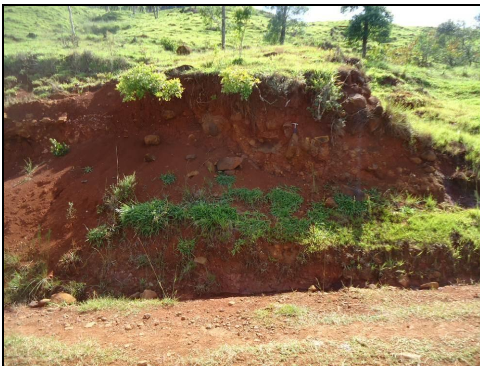
Figura 57 – Solo/rocha parcialmente expostos no talude da via de acesso.
